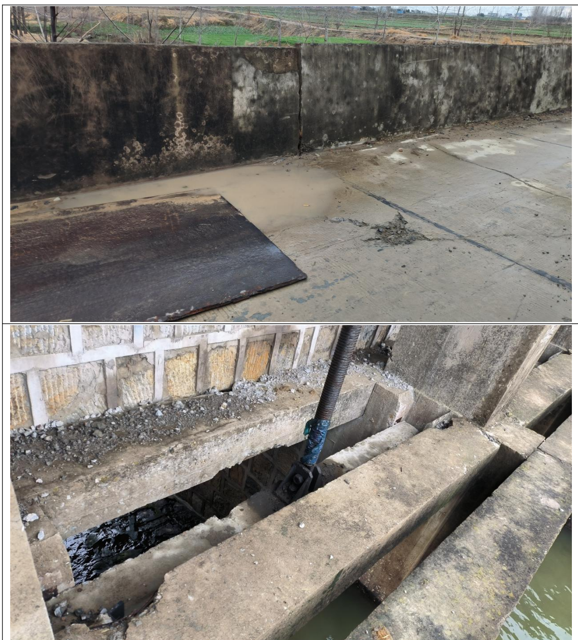
图 2.1.1 小温郢泄洪闸破损 (g116.99767369,32.29634950)
